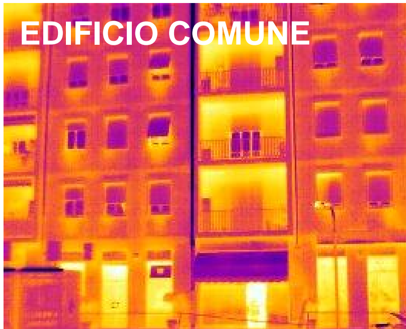
Termografia di edificio esistente non isolato adeguatamente
