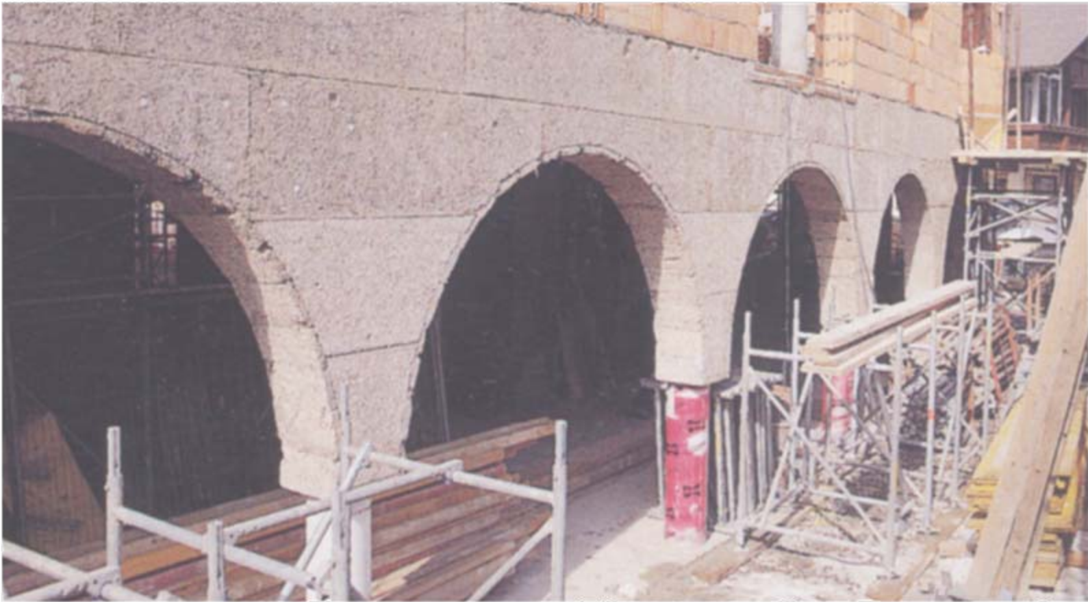
Ponte termico isolato con pannelli Celenit N spessore 35 mm.
