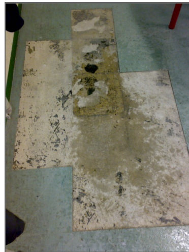
Le piastrelle scollate a causa della pioggia
